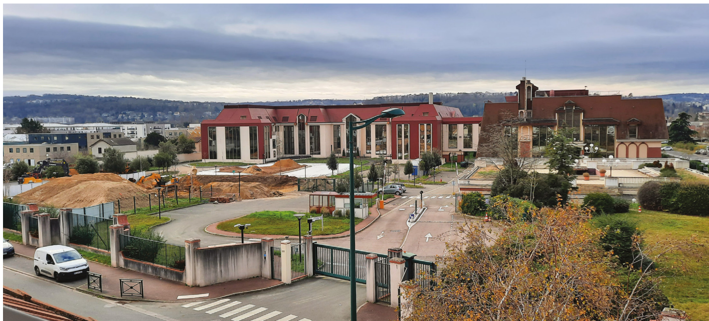
Ancien établissement Servier à Croissy-sur-Seine au moment des travaux de dépollution du sol dans le périmètre de l'ancienne cuve Sovcor (déc. 2023) - ©AdCR
